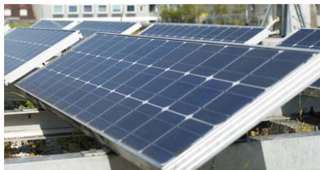
Solarstrom durch Photovoltaik: Sonnenenergie liefert so umweltfreundlichen Strom – 365 Tage im Jahr.
