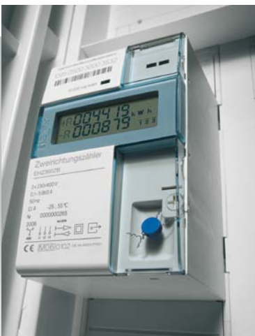
Überwacher und Energiesparhelfer: ein intelligenter Stromzähler.
